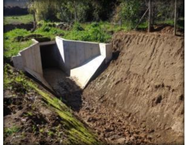
Cámara de salida de Sifón Fortaleza.
