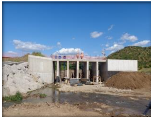
Bocatoma Canal Norte Unificado, barrera frontal.
